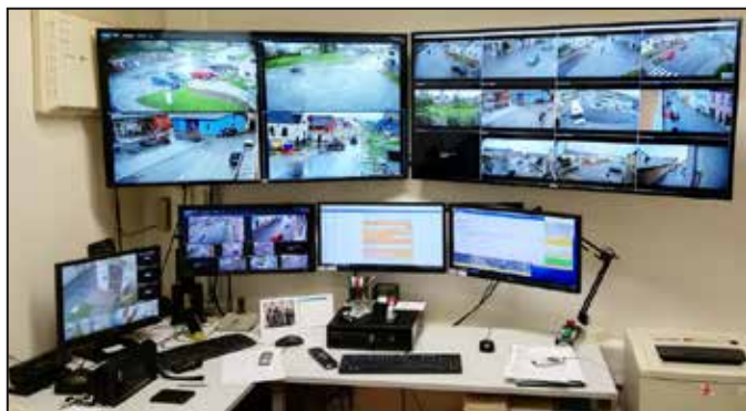
Nové monitory 55" na služebně v Mohelnici
